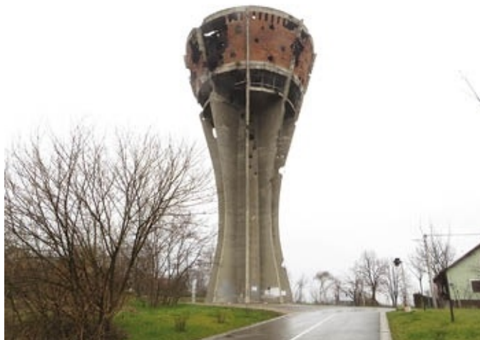
Torre del agua de Vukovar, con impactos provocados por el ataque.
